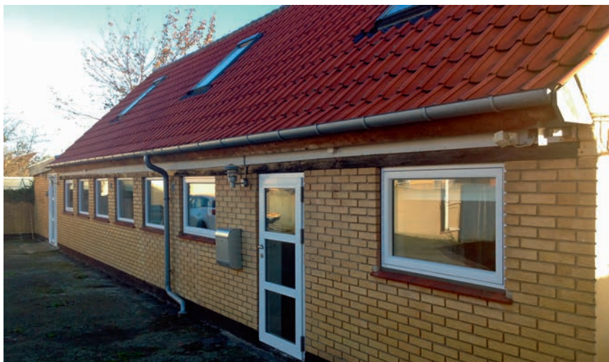
Klubmedlemmer lagde selv arbejdskraft til, da Nexø Rks nye hus blev sat i stand.
